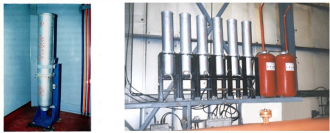
Рис.2 Внешний вид ГОА АГАТ-2А (а) и установки из нескольких генераторов АГАТ-2А на ГПА "COBERROW" ООО "Сургутгазпром" (б)
