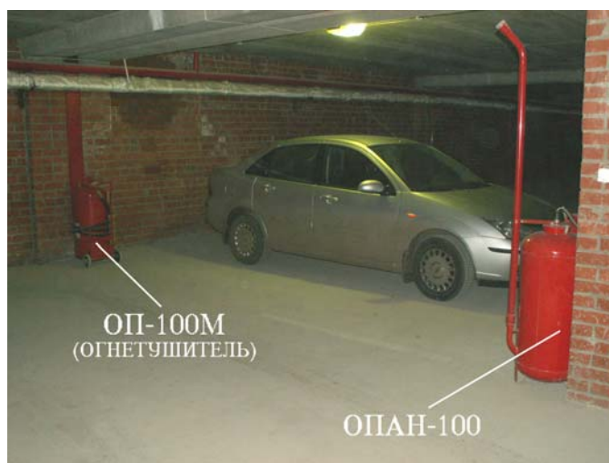
Рис. 5. Расположение модулей ОПАН-100 и огнетушителей ОП-100М на манежной стойке паркинга.
