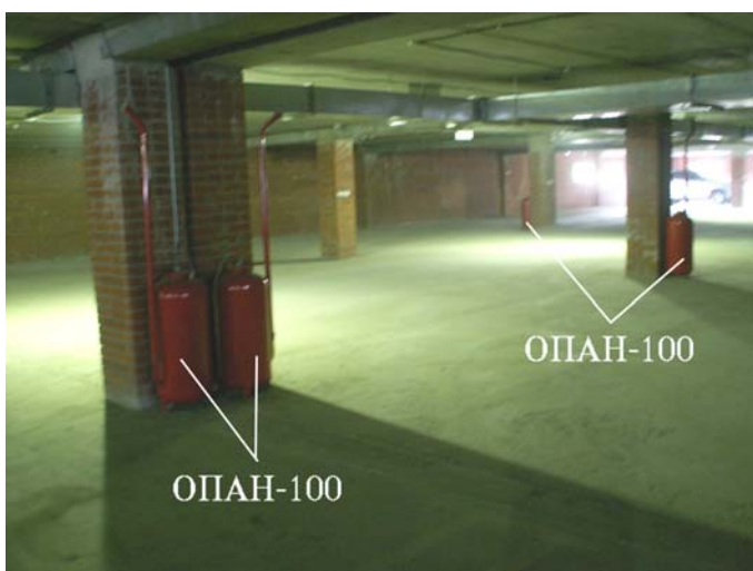
Рис 6. Расположение модулей ОПАН-100 на манежной стойке 3-го этажа паркинга.
