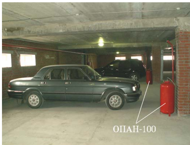
Рис. 3. Расположение модулей ОПАН-100 на манежной стойке 2-го этажа паркинга.
